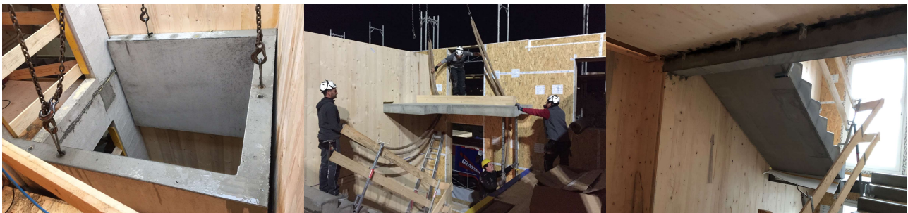
MONTAGEBAUWEISE tragende Stiegenhauswände in BSP innerer Liftschacht, Stiegenläufe und Podeste in STB Fertigteil
